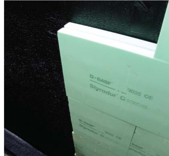
Lämmöneristyslevyt voidaan helposti kiinnittää kaksikomponenttisilla KÖSTER Polymerimodifioituilla bitumipaksukalvoilla. On tärkeää että levyt on kokonaan liimattu.
