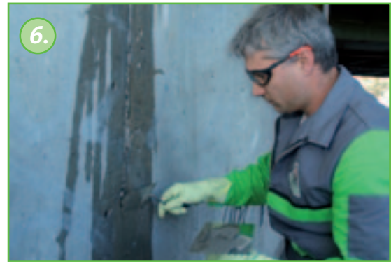
6. Sulje halkeama sen kulkusuunnassa KÖSTER KB-Fix 5 materiaalilla. Halkeaman sulkeminen ehkäisee injektointimateriaalin ennenaikaista valumista ulos halkeamasta injektoinnin aikana. Kovettumisaika on n. 5 minuuttia riippuen ympäröivästä lämpötilasta ja ilmankosteudesta.
